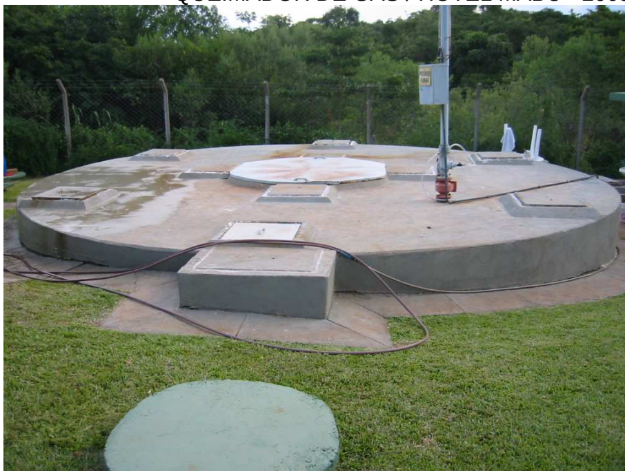
FIGURA 28 – RALF (REATOR ANAERÓBIO DE LODO FLUIDIZADO) E O QUEIMADOR DE GÁS / HOTEL MABU - 2005
