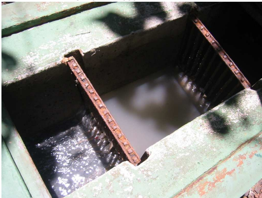
FIGURA 25 – FASE PRIMÁRIA DE TRATAMENTO DE EFLUENTE DO HOTEL TROPICAL - 2005
