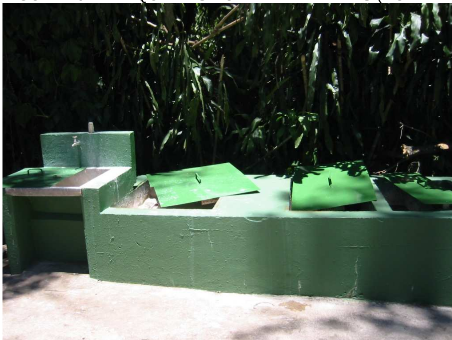
FIGURA 29 – TANQUE RESIDUAL DE MATERIAIS (HOTEL TROPICAL) - 2005
