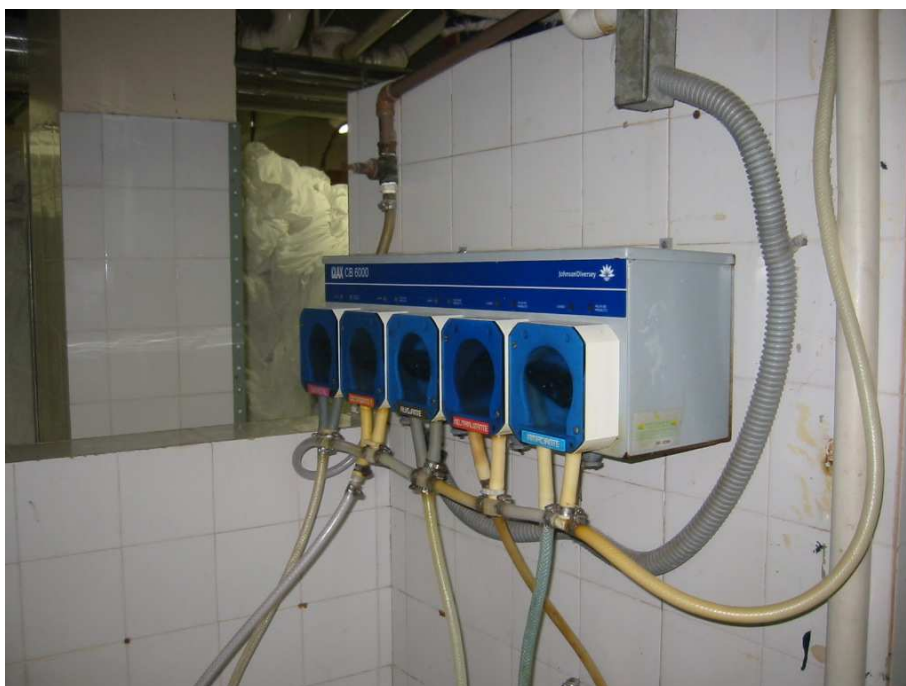
FIGURA 07 – DOSADORES UTILIZADOS NA LAVANDERIA DO HOTEL TROPICAL - 2005
