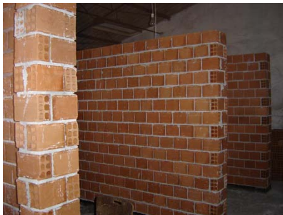
Figura 10 – Paredes de alvenaria de 450 cm de largura por 230 cm de altura sem chapisco
