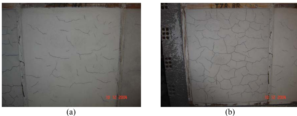
Figura 38 – Painéis das argamassas T7 com traço em volume 1 : 3 : 8 sendo: (a) com areia natural e (b) com areia britada. As fissuras foram reforçadas com lápis preto para facilitar a visualização e a medição
