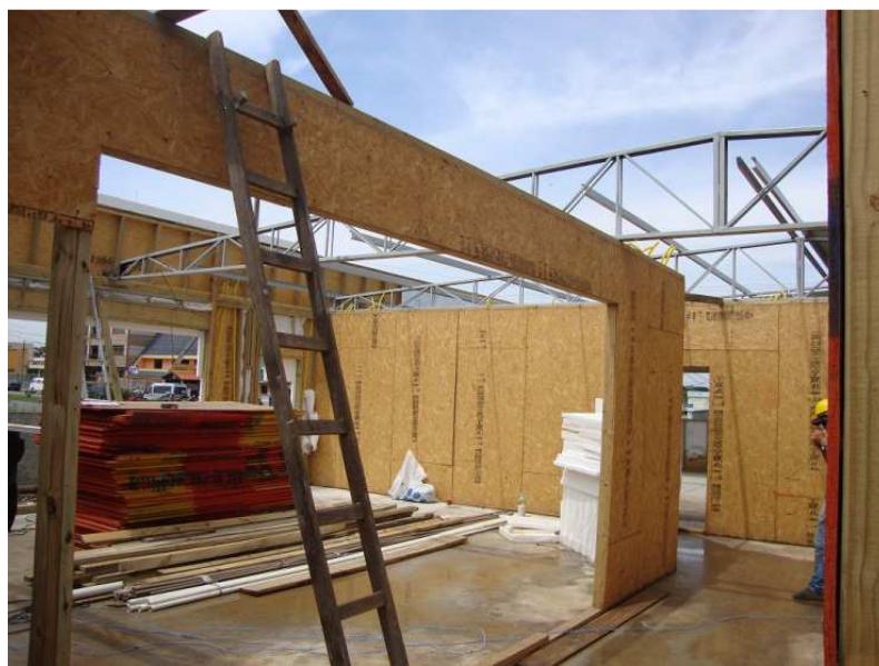
Fotos 01 e 02 – Início da montagem dos painéis OSB sobre a laje radier, com estrutura em pinus autoclavado e travamento superior em tesouras metálicas
