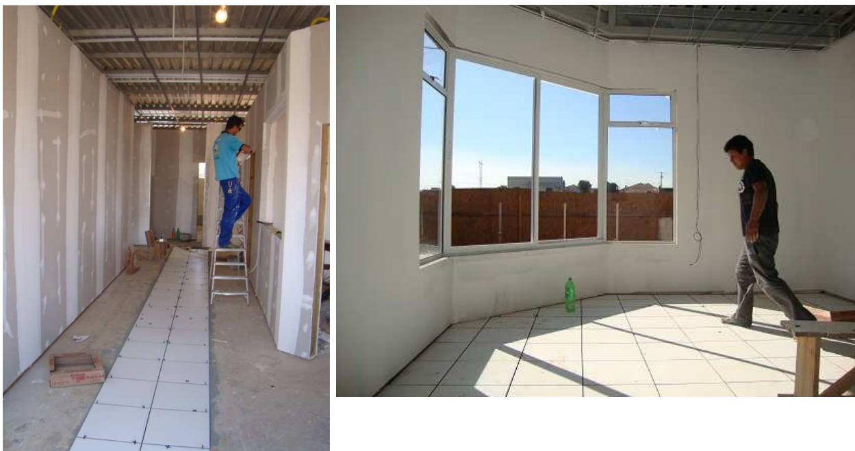
Fotos 10 e 11 – acabamento interno com Revestimento com gesso acartonado e piso cerâmico
