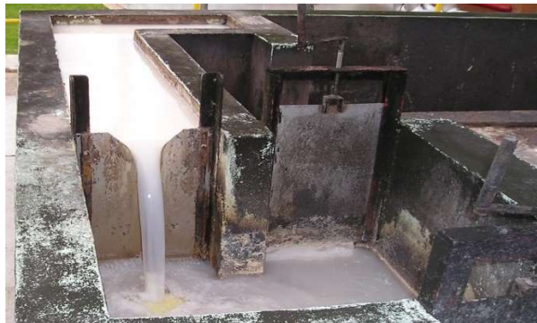
FIGURA 5 - ENTRADA DO EFLUENTE INDUSTRIAL
