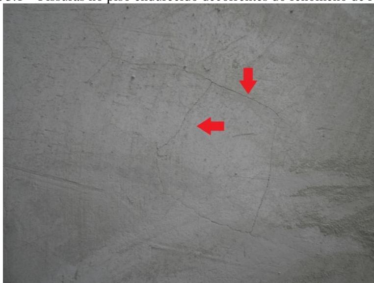
Figura 3.1 – Fissuras no piso endurecido decorrentes do fenômeno de retração.
