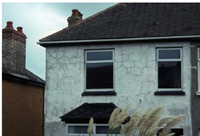
Figura 6. Fissuras Irregulares – Casa próxima a Camborne.
