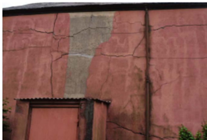
Figura 7. Fissuras mapeadas em uma parede de concreto severamente degradada – Propriedade comercial em Camborne.
