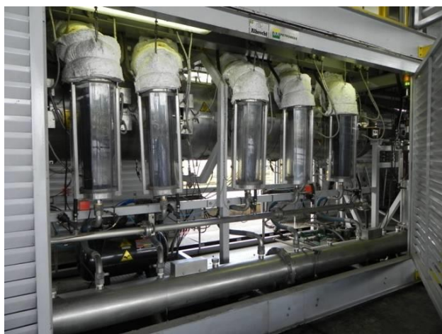
Figura 7 - Sistema de condensação da unidade térmica semi-industrial TELAB K200.
