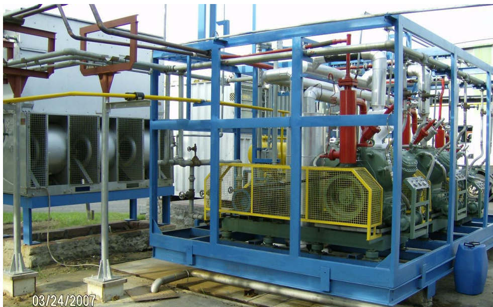
FIGURA 5 - UNIDADE DE ARMAZENAMENTO DE SUBSTÂNCIAS REFRIGERADAS FONTE: ALLGAYER (2010)
