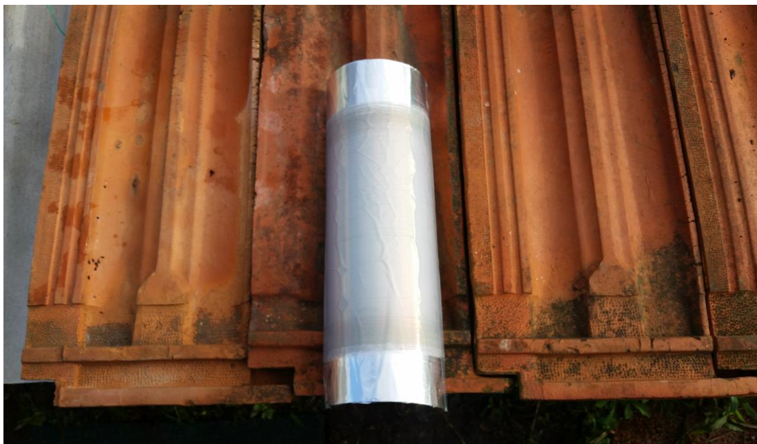
Figura 33 – Termopar instalado na superfície da telha cerâmica – depois da proteção.
