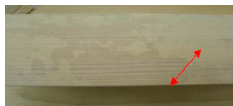
Figura 25 - Manchas na madeira de Freixo
