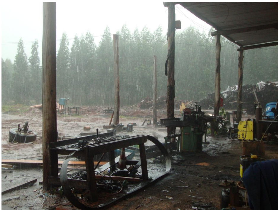
FOTO 53 - COBERTURA DO BARRACÃO É INSUFICIENTE PARA PROTEGER OS EQUIPAMENTOS DAS CHUVAS. FONTE: O autor (2013)
