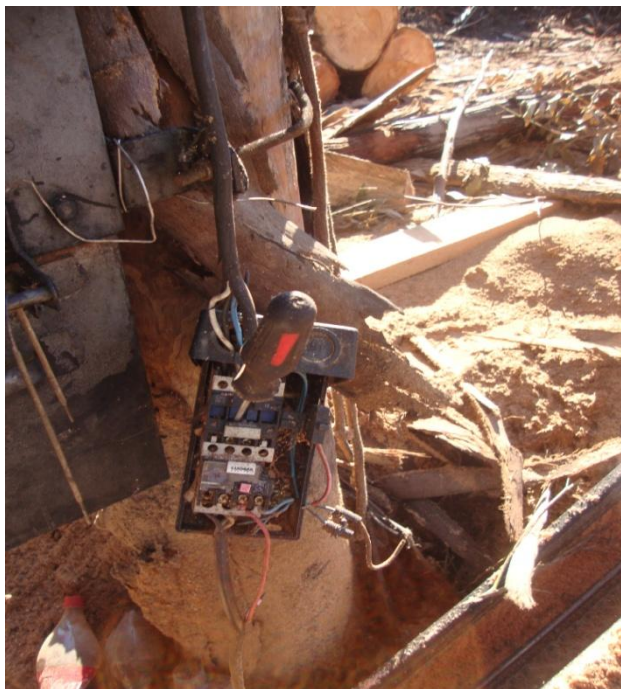
FOTO 29 - DETALHE DE LIGAÇÃO ELÉTRICA FEITA INCORRETAMENTE. A CHAVE DE FENDA ACIONAVA A ESTEIRA TRANSPORTADORA DE SERRAGEM.
