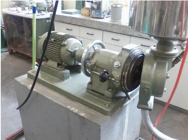
FIGURA 8 - EQUIPAMENTO SEM PROTEÇÃO E SINALIZAÇÃO FONTE: O AUTOR (2014)
