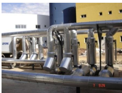
Figura 19 – Linha de água gelada isolada com camada exterior de alumínio. Fonte: (Site Maranata montagem industrial).
