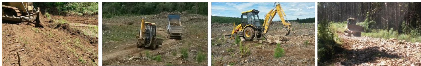
FIGURA 6 - SISTEMA DE MANUTENÇÃO DE VIA - A) RASPAGEM DE RAMAL TRATOR D50; B) CARREGAMENTO E TRANSPORTE DE CASCALHO - MERCEDES; C) ESPALHE DE CARGA – RD406ADV; D) COMPACTAÇÃO DO LEITO E MANUTENÇÃO DE SARJETAS – D51 EX-22
