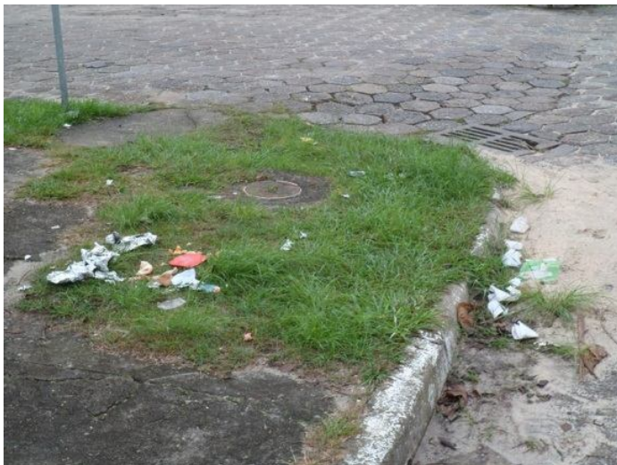
FIGURA 5: RESÍDUOS PRÓXIMOS A BUEIRO PARA ESCOAMENTO DE ÁGUAS PLUVIAIS.
