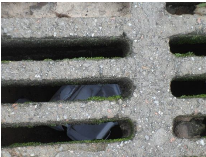
FIGURA 6: RESÍDUO NO BUEIRO PARA ESCOAMENTO DE ÁGUAS PLUVIAIS.
