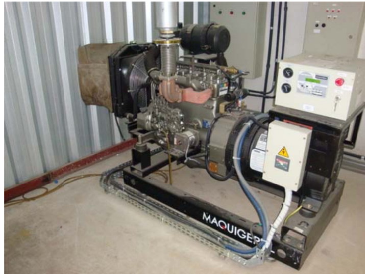
FIGURA 3.5 GRUPO GERADOR INSTALADO
