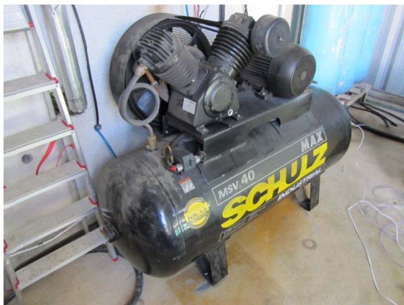
FIGURA 3.14 COMPRESSOR DE AR SCHULZ MSV 40
