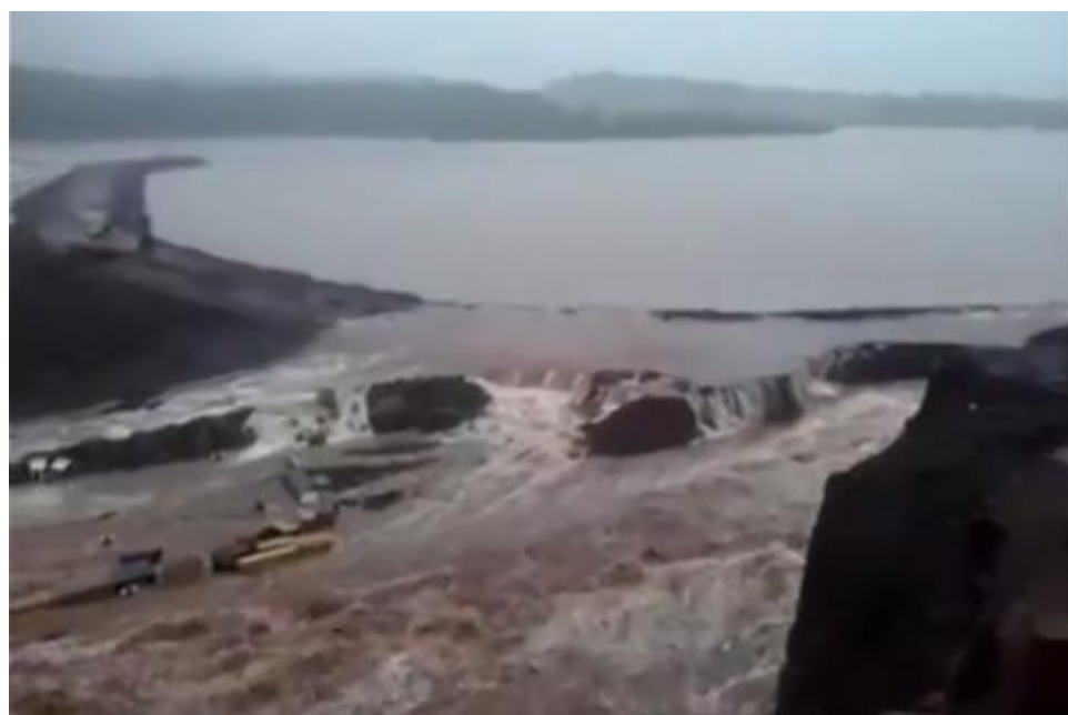
Figura 12: Imagem do canteiro de obras da UHE Baixo Iguaçu no momento do rompimento das ensecadeiras. 174
