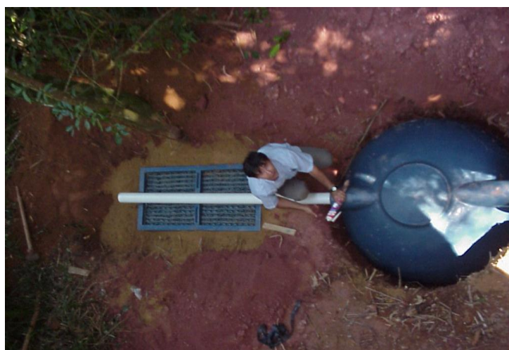
Figura 27- Mini Estação de Tratamento de Esgoto (Fotos Cedidas pela empresa IDHEA)
