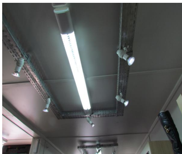
Figura 19. Área Interna – Lâmpada LED e Fluorescente.
