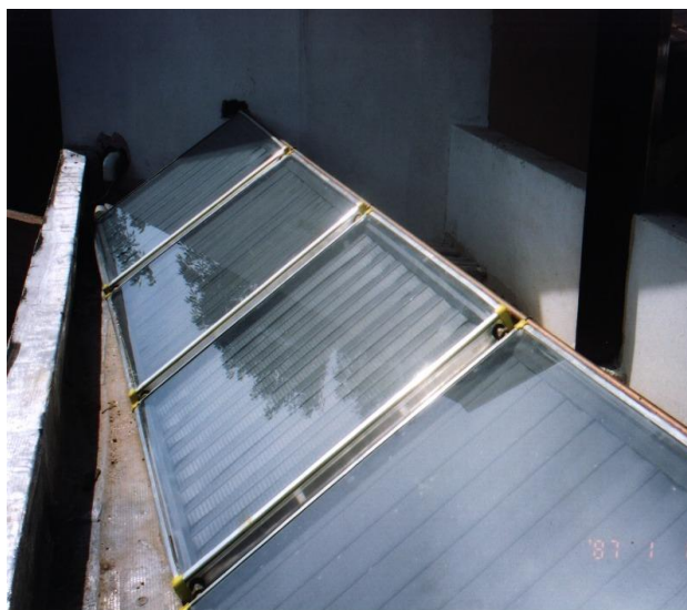
Figura 32 - Placas de Aquecedor Solar
