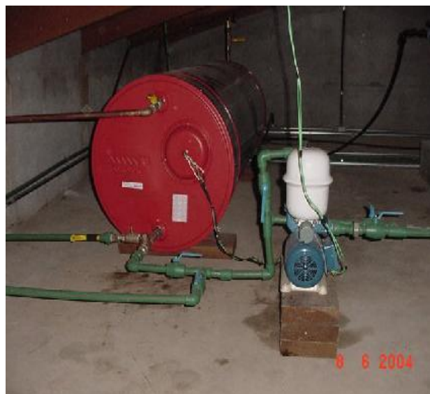
Figura 33 - Boiler e Pressurizador
