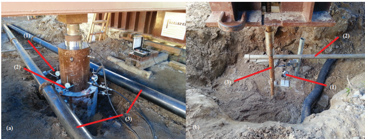
Figura 3.12 - Monitoramento dos deslocamentos, figura (a) estaca teste: (1) extensômetro; (2) extensômetro; (3) vigas de referência; figura (b) estaca de reação: (1) extensômetro; (2) viga de referência; (3) barra de Dywidag
