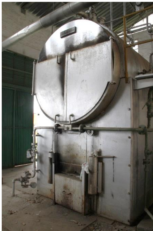
FIGURA 40 – CALDEIRA PARA A PRODUÇÃO DE VAPOR ORIGINAL DA MÓVEIS CIMO S.A. – VILA NOVA, RIO NEGRINHO – SC. FONTE: A autora (2015).
