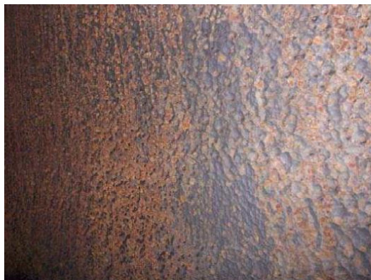
Figura 12: Corrosão homogênea em costado de torre (aspecto de casca de laranja).
