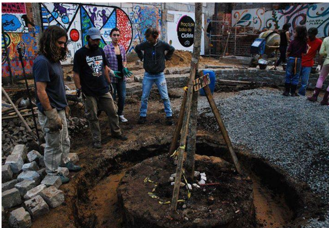
Figura 23 – Simultaneidade dos trabalhos: construção do muro ao fundo, do banco curvo central e da base do banco redondo.
