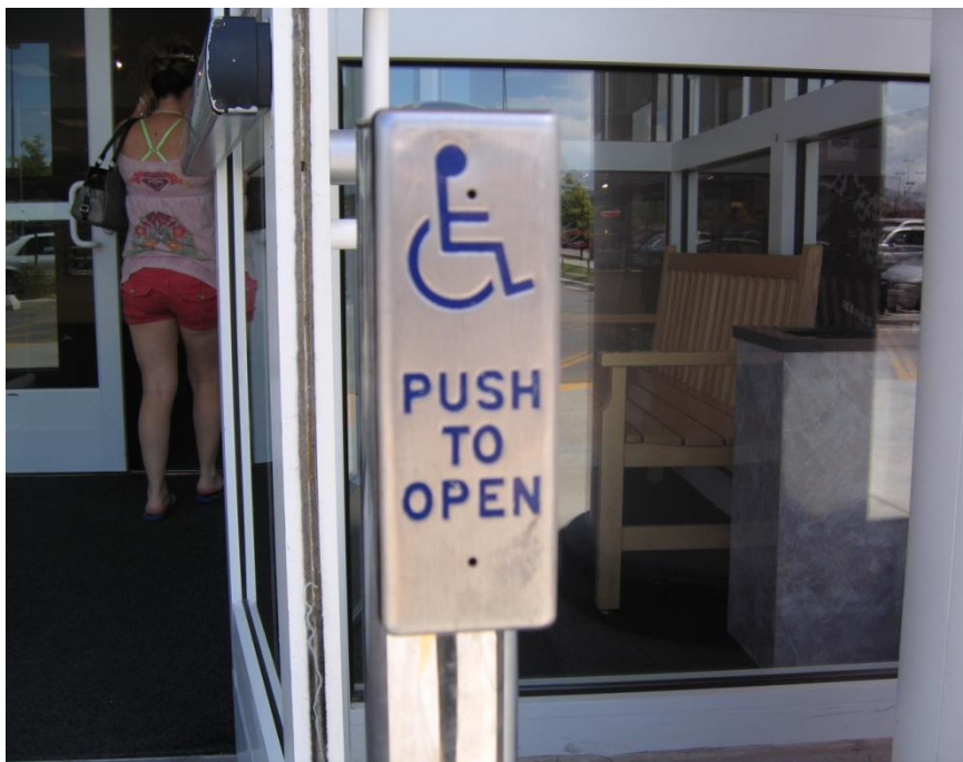
Figura 43: Dispositivo a ser ativado para que a porta abra automaticamente não havendo necessidade do esforço físico Fonte: acervo pessoal, 2010
