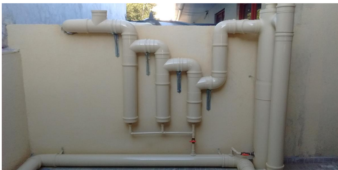
Ilustração 13 - Sistema de captação de água pluvial
