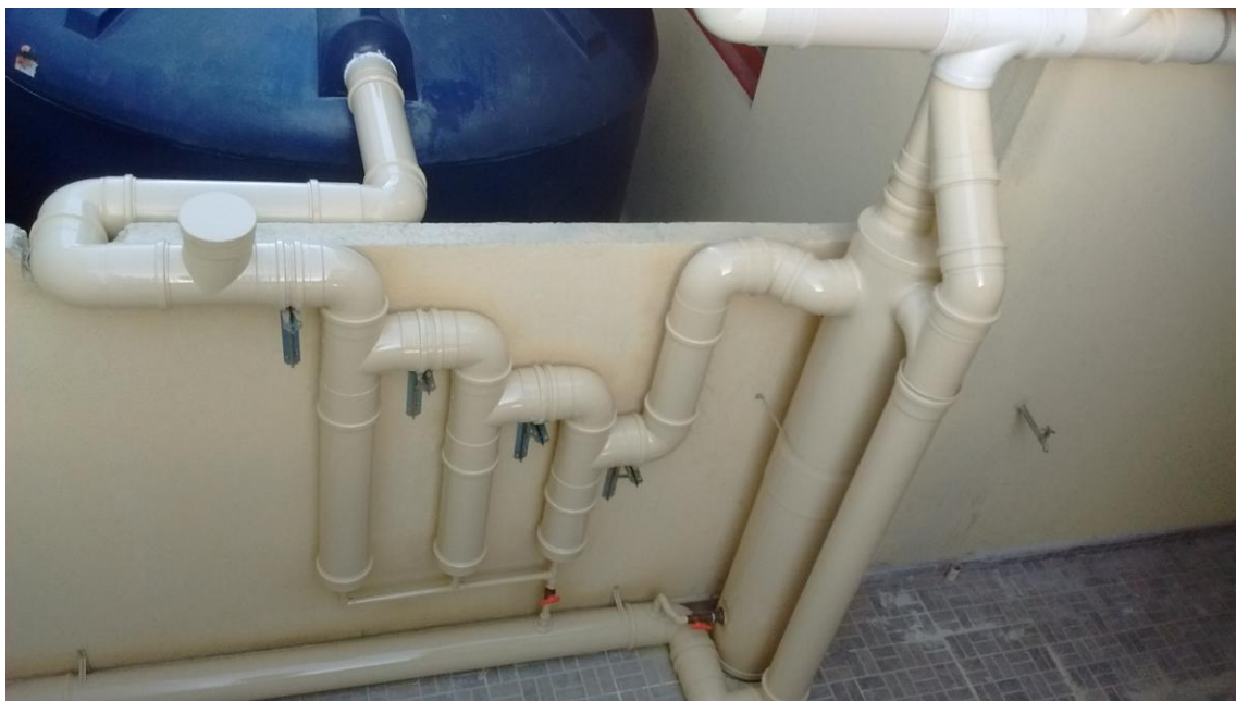
Ilustração 14 - Sistema de captação de água pluvial
