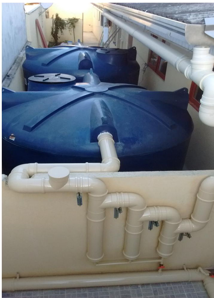
Ilustração 12 - Sistema de captação de água pluvial
