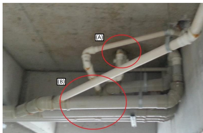
Figura 30 – produto 2: (a) acentuada queda por desnível; (b) encontro antecipado das tubulações.
