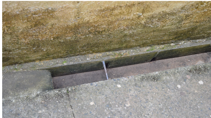
FIGURA 62 - CANALETA SEM GRELHA FONTE: O autor (2014)
