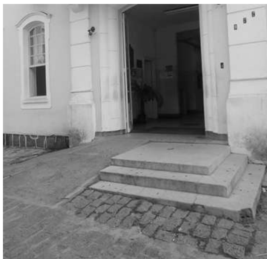
Figura 7: Rampa sem corrimão.
