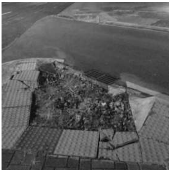
Figura 2: Rampa destruída em Curitiba.
