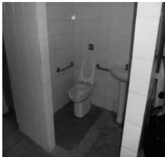
Figura 5: Banheiro não adaptado.
