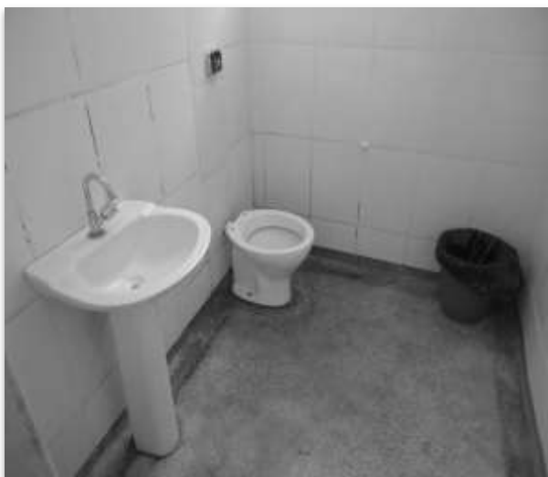
Figura 6: Banheiro sem barras.
