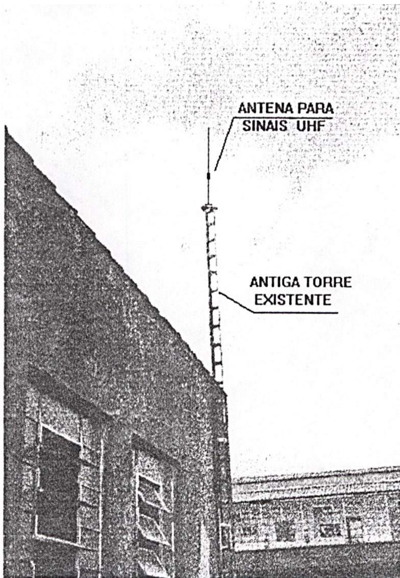
FIGURA 07 - ESTAÇÃO BASE (ETS) - TORRE 01
