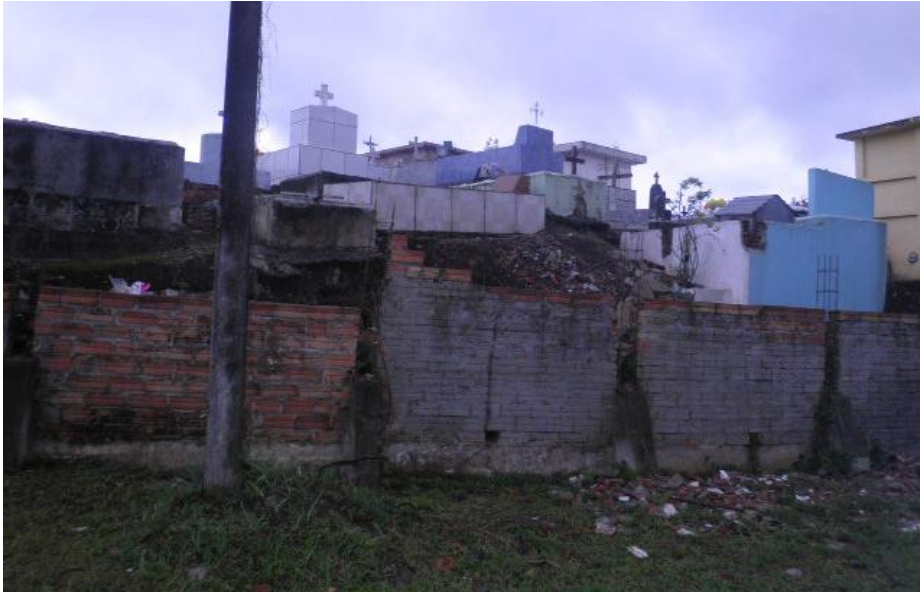
FIGURA 34 – MURO DE DELIMITAÇÃO DO CEMITÉRIO E PROCESSOS EROSIVOS - SÃO CRISTÓVÃO FONTE: acervo da autora (2013).
