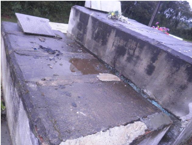
FIGURA 32 – TÚMULOS COM DEFICIÊNCIA NA VEDAÇÃO – CEMITÉRIO SÃO CRISTÓVÃO FONTE: acervo da autora (2013).
