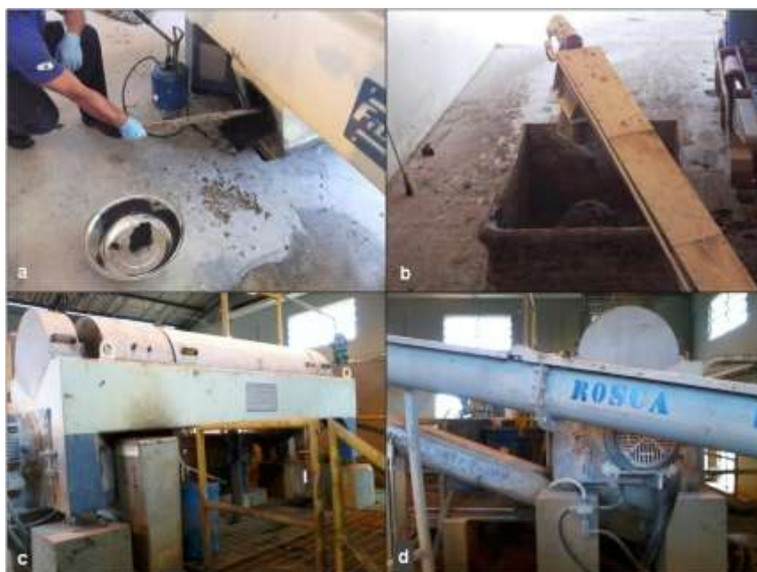
FIGURA 3.1 – AMOSTRAGEM DE LODO: a) COLETA DE LODO CENTRIFUGADO-ETE BELÉM; b) SAÍDA DE LODO CENTRIFUGADO E CALEADO – ETE BELÉM; c) CENTRÍFUGA- ETE ATUBA SUL; d) SISTEMA PARA CALEAÇÃO DE LODO- ETE ATUBA SUL
