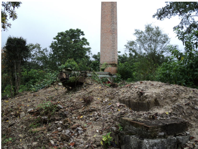
FIGURA 5 – ENGENHO CENTRAL EM RUÍNAS; AS PAREDES DA RODA D'ÁGUA E A CHAMINÉ (AO FUNDO) AINDA PERMANECEM EM BOM ESTADO DE CONSERVAÇÃO.
