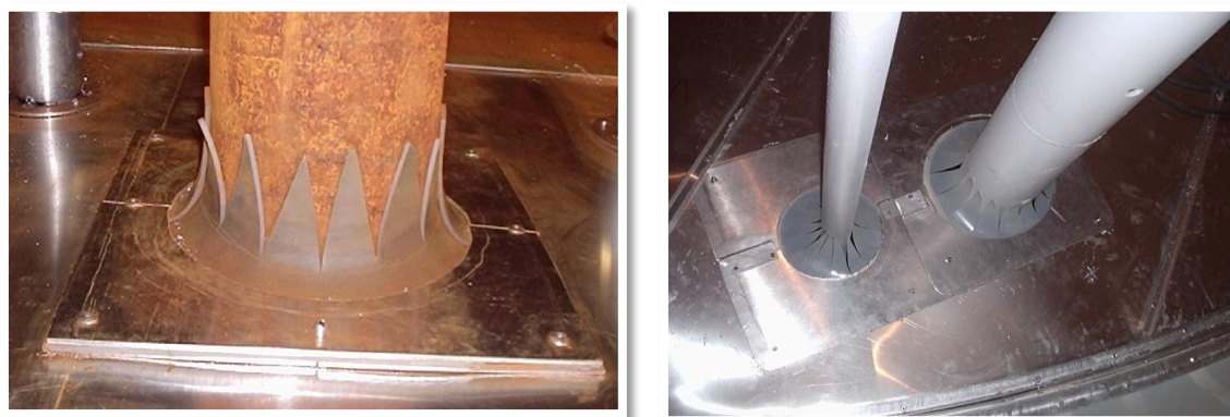
FIGURA 7 - INTERFERÊNCIAS DE TUBULAÇÕES NO TETO FLUTUANTE INTERNO FONTE: VETOR-MATHIAS; 2015
