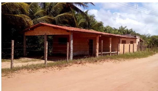
Figura 23 – Casa pintada de terra com a ação dos ventos fortes
