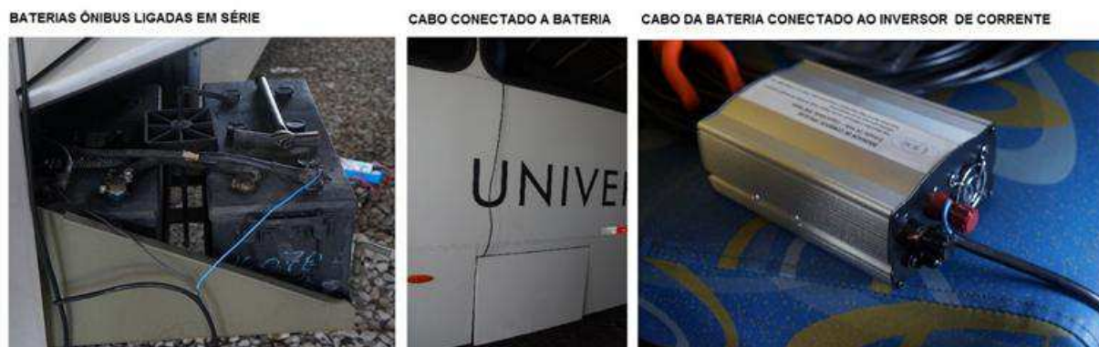
FIGURA 28 - FOTOGRAFIAS DA LIGAÇÃO ENTRE BATERIA E INVERSOR FONTE: o autor (2015).
