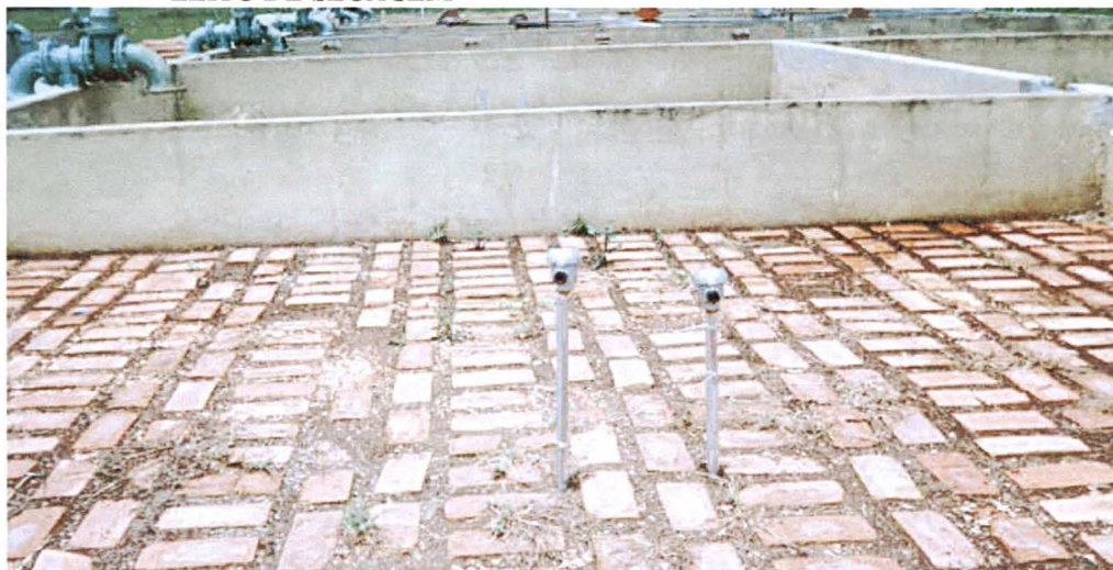
FIGURA 14 – ILUSTRAÇÃO DA INSTALAÇÃO DOS SENSORES DE TEMPERATURA DENTRO DO LEITO DE SECAGEM
