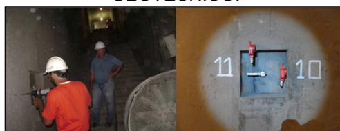
FIGURA 13 - FIXAÇÃO DOS PONTOS DE MONITORAMENTO JUNTO AO INSTRUMENTAL GEOTÉCNICO.
