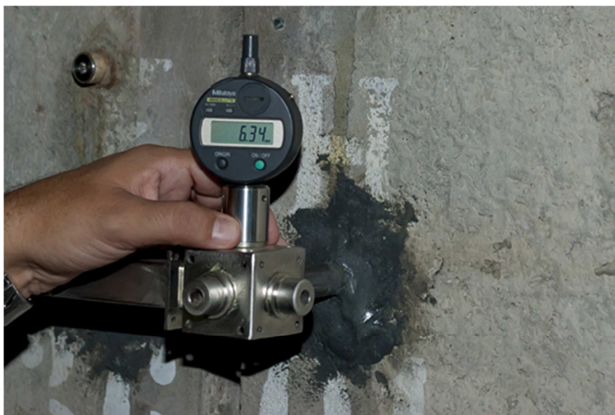
FIGURA 2 – RELÓGIO COMPARADOR DIGITAL SENDO USADO PARA EFETUAR LEITURA EM UM MEDIDOR TRIORTOGONAL DE JUNTA NA BARRAGEM DA USINA DE ITAIPU
