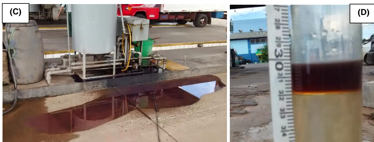
Figura 8 – Exemplos de não conformidades ambientais em postos de combustíveis (A) Produto vazado e acumulado em sump de bomba; (B) Piso e canaleta em más condições (C) Derrame de produto durante transferência; (D) Produto em água subterrânea oriundo de vazamento Fonte: Finkler Ambiental (imagens cedidas)
