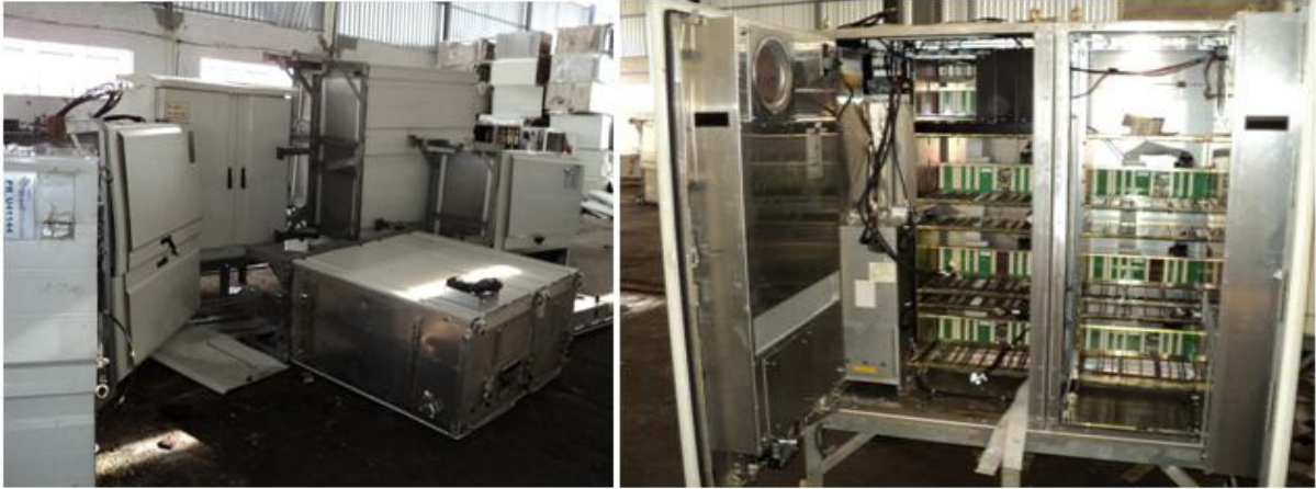
FIGURA 6 – Central de telefonia móvel. FONTE: O autor (2011).
