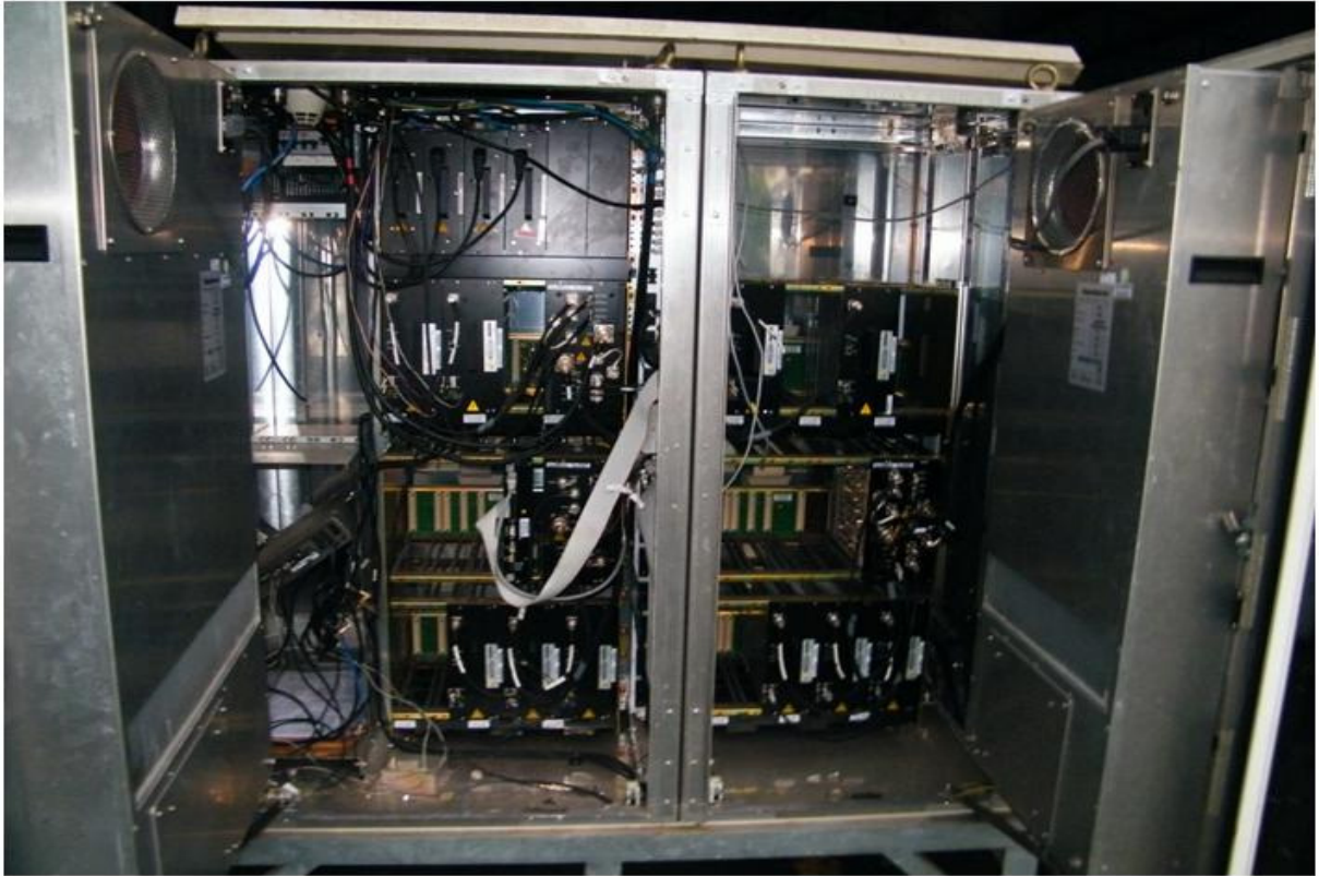
FIGURA 3 – Central de Telefonia Móvel
