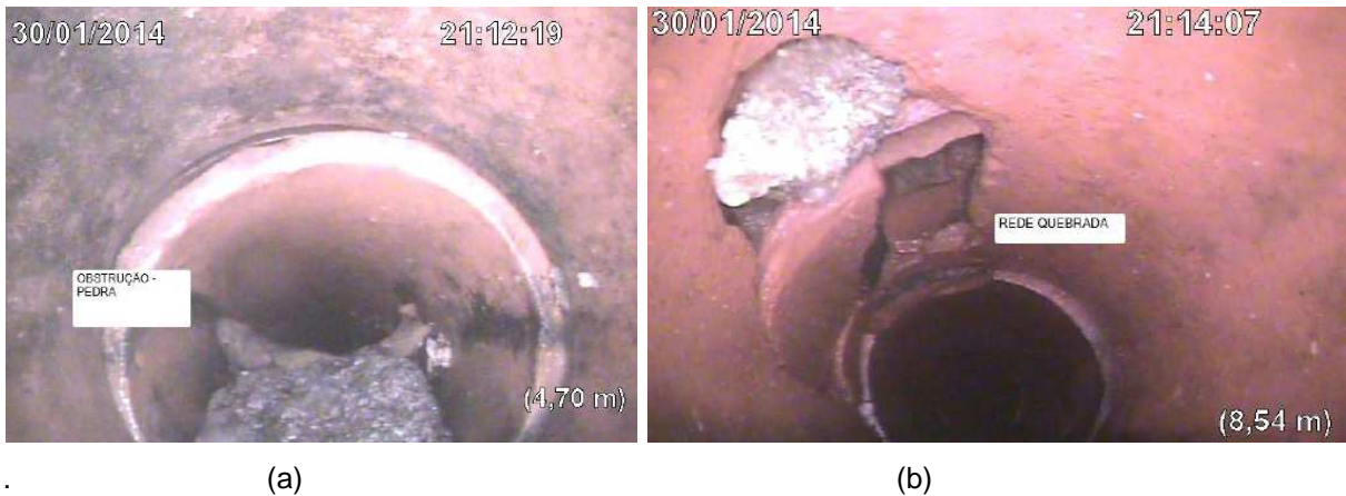
FIGURA 18 – IMAGENS DE TUBULAÇÃO OBSTRUÍDA POR PEDRA (a) E COM AVARIA FÍSICA (b) FONTE: DOBIGNIES (2014)
