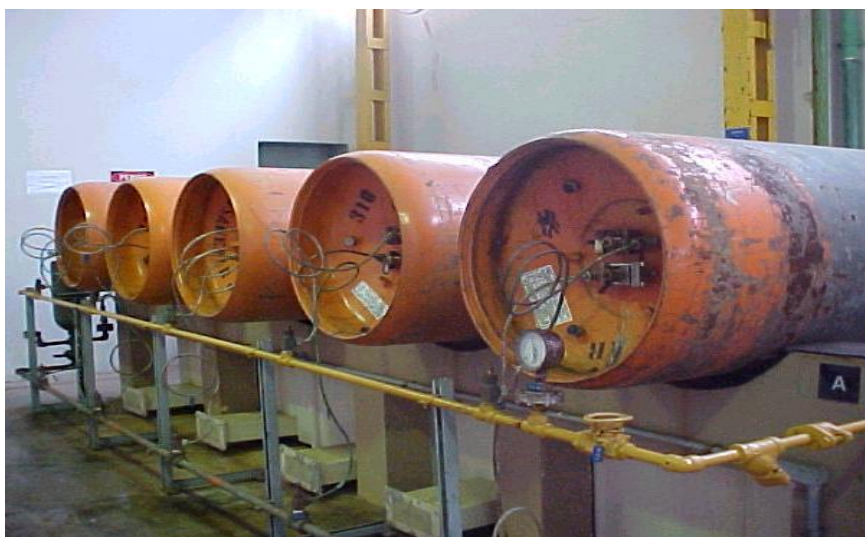
Figura 07 - Cilindros de cloro gasoso.
