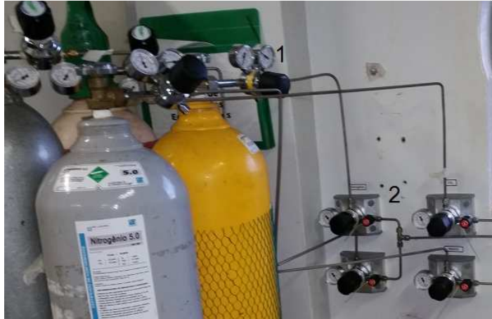
FIGURA 7- LINHA DE GASES E REGULADORES DE POSTO DO REATOR.
