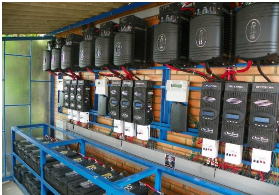
Figura 16 - Armário de Equipamentos Instalado
