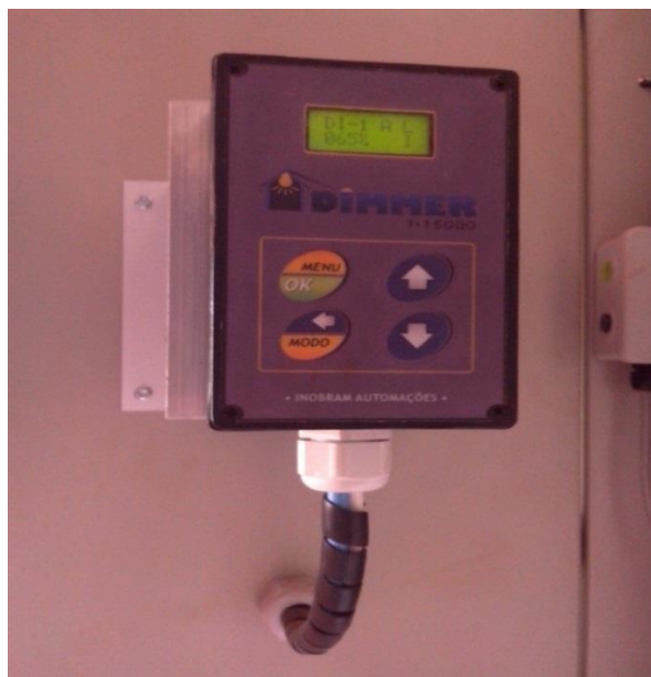
Figura 19 - Dimmer para controle da iluminação.
