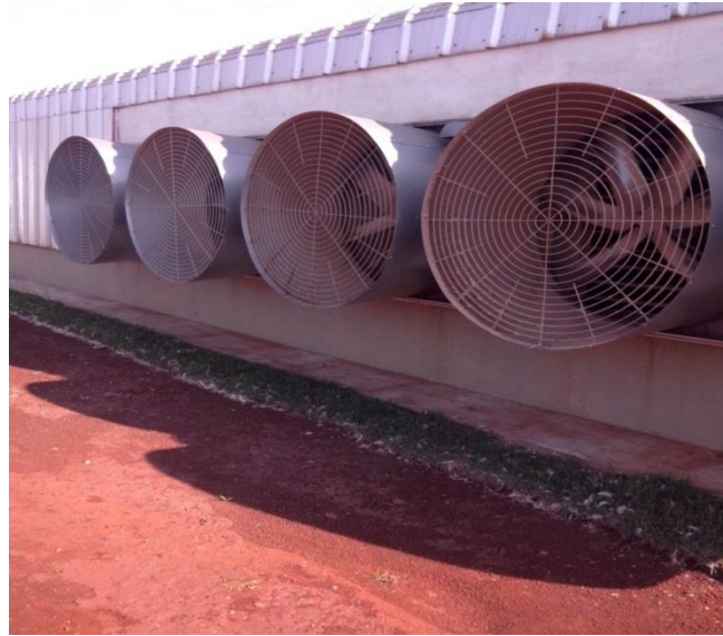
Figura 16 - Exaustores nas laterais do aviário.
