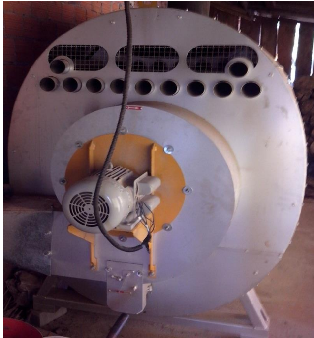
Figura 12 - Forno para aquecimento.
