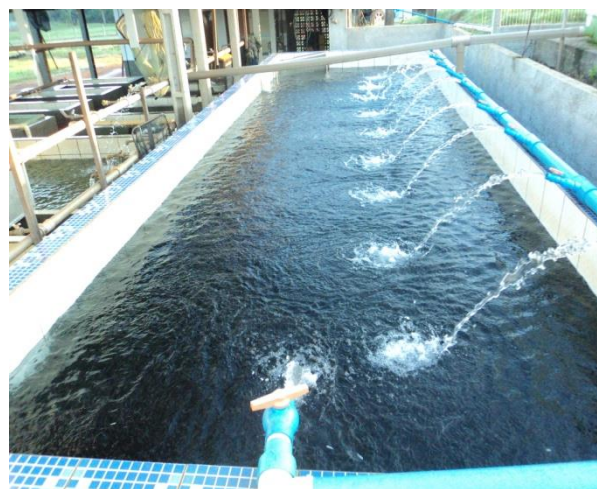
Figura 18. Tanque de depuração
