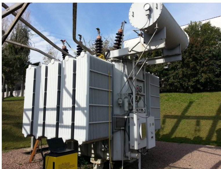
Figura 33. Transformador de 6 MVA utilizado nos ensaios de SFRA
