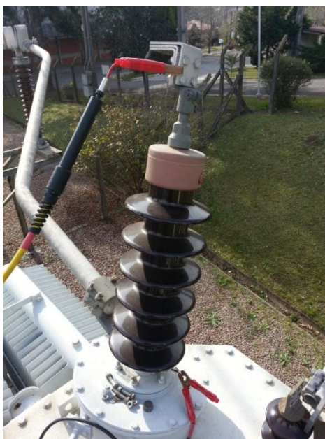
Figura 38. Medição da capacitância C1 no transformador em campo
