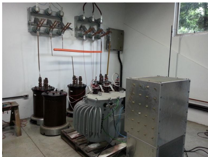
Figura 50. Carga resistiva trifásica alimentada por transformador trifásico de 112,5 kVA e conjunto de TPs e TCs de medição
