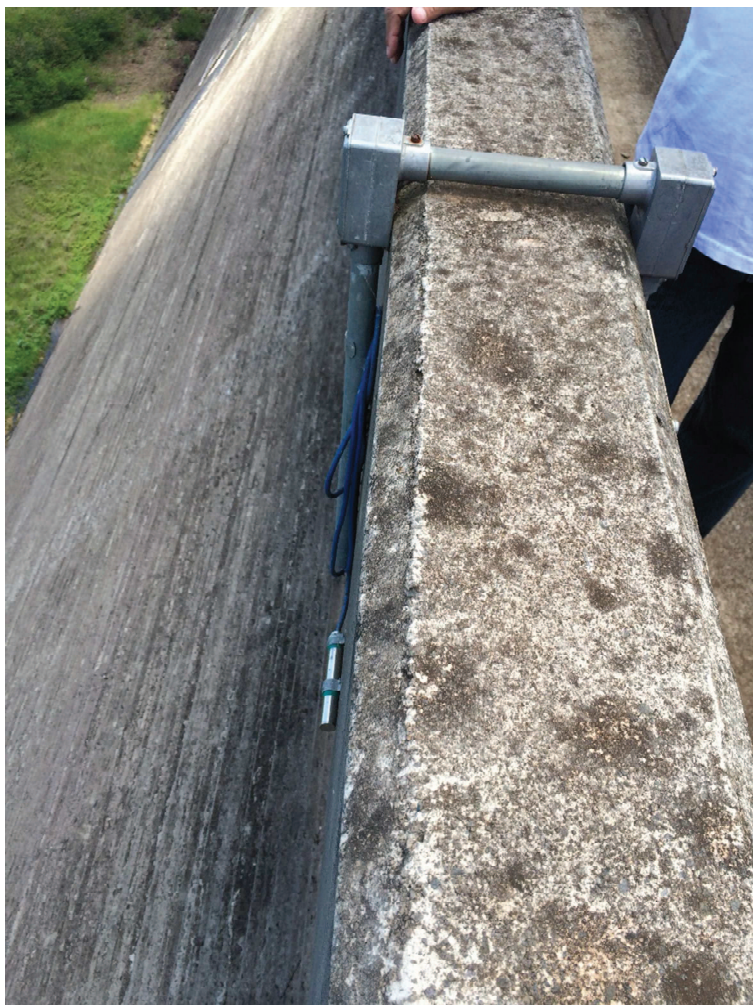
Figura 15 – Foto do termômetro de superfície TER1, localizado na face de jusante da barragem da UHE GJR Fonte: Autora (2014)
