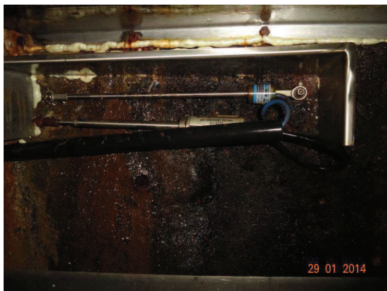
Figura 13 – Foto do fissurômetro FIS3, instalado na galeria inferior da barragem da UHE GJR Fonte: Autora (2014)
