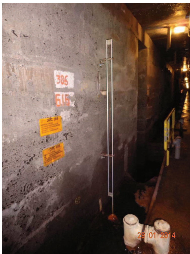
Figura 14 – Foto do medidor de vazão MVZ6, localizado na galeria inferior da barragem da UHE GJR Fonte: Autora (2014)
