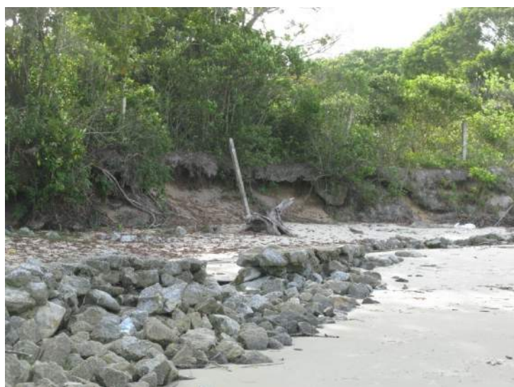
FIGURA 10: FALÉSIA E CERCA CAÍDA, INDICANDO EROSIÃO NA REGIÃO DO PERFIL 3
