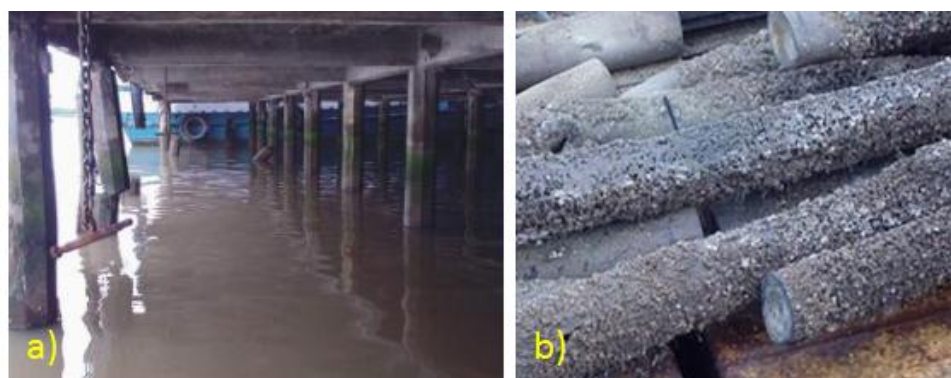
FIGURA 1.2 - (a) ESTACAS DE CONCRETO QUE SOFRERAM IMPACTOS DE BARCOS. (b) EXEMPLO DE ESTACAS DETERIORADA PELA BROCA DA MADEIRA ( TEREDO NAVALIS ). OBRAS EM ITAJAÍ-SC.
