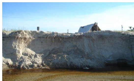
FIGURA 2 – EROSÃO A NORTE DA DESEMBOCADURA COLOCANDO EM RISCO ESTRUTURAS DE PESCADORES
