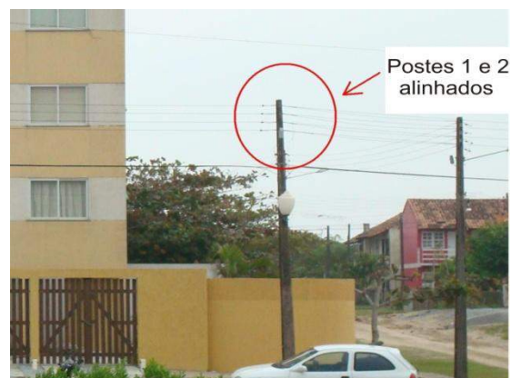
FIGURA 12 – ALINHAMENTO DOS POSTES
