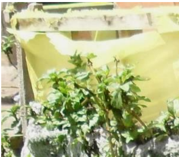
Figura 64 – Danos causados a lona plástica na parte superior do painel na fachada Norte. Fonte: O autor, 2013.
